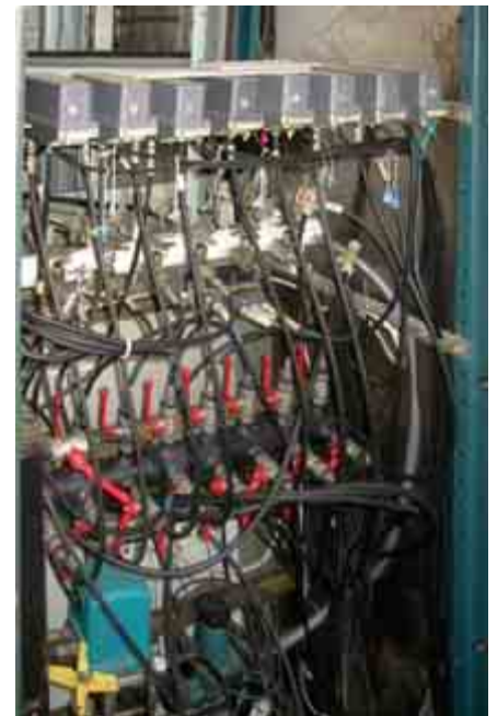
Рис. 4. Шкаф с преобразователями ЭПП и ПЭП
